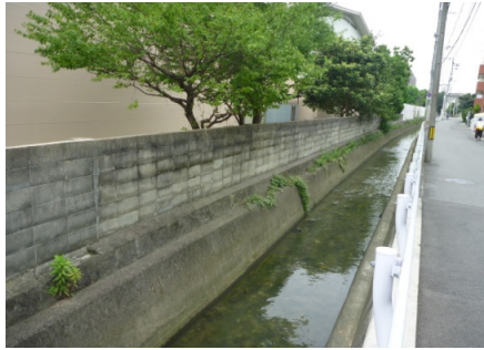
文京3番地区北側ブロック塀
