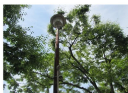
腐食による照度低下
