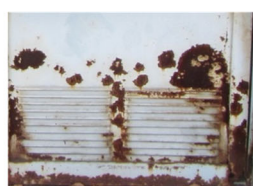
開閉が困難な扉
