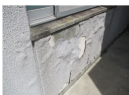
ひび割れ、広範囲の剥がれ
