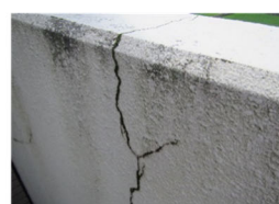
藻が繁殖したひび割れ
