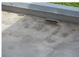
ふくれ、しわ、漏水痕
