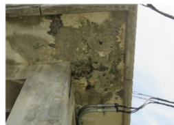
ひび割れ、損壊
