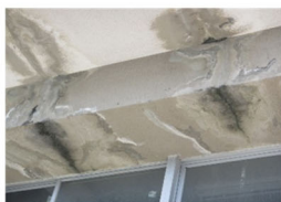
補修後も雨漏れ
