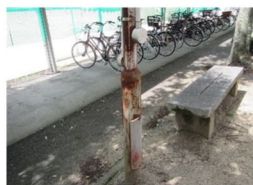
ポール倒壊のおそれ
