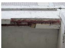
スラブ底の剥落
