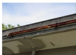
配管落下のおそれ
