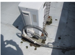
保温材の欠落で電線剥き出し
