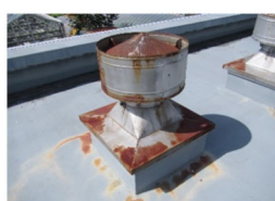
換気設備の腐食
