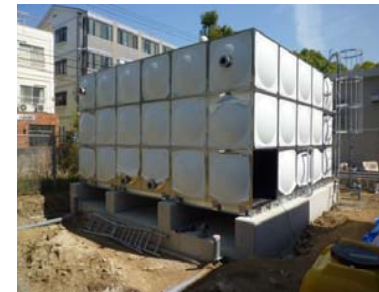
【受水槽設置状況】
