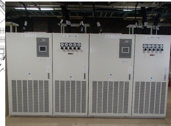
配電室更新後
