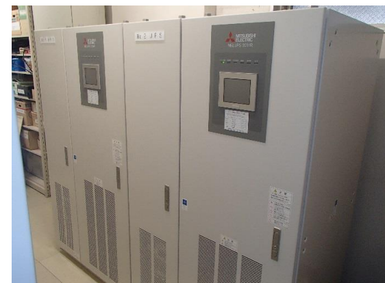
防災センター更新後
