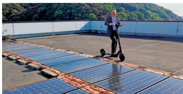
図2 工学部5号館屋上に設置されている4kWの太陽光パネルと電動キックボードの写真
