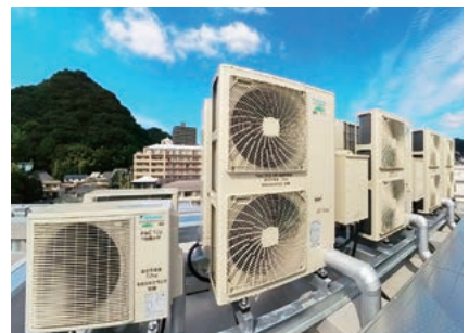
高効率空調設備への更新
