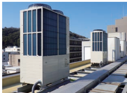
高効率空調設備への更新
