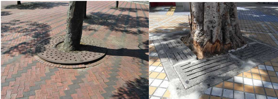
写真 踏圧防止板の不陸 8)
