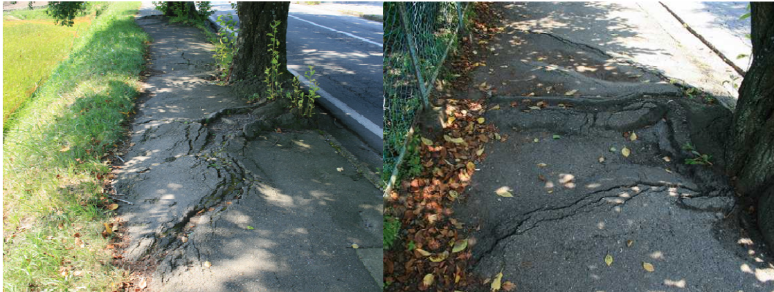
写真 舗装部の根上がり 8)
