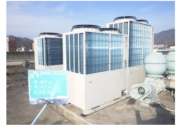
室外機改修後
