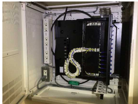
情報通信網設備 完成
