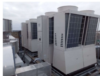
屋上 空調室外機
