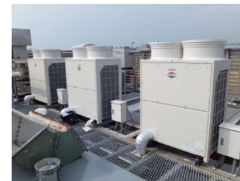
屋上 空調室外機
