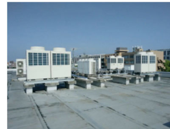
屋上 空調室外機
