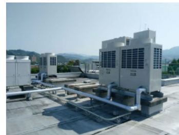
屋上 空調室外機
