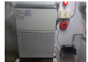
機械室 除湿機
