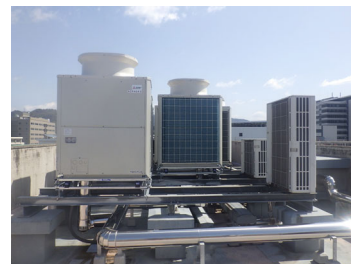
屋上 空調室外機
