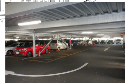
立体駐車場 照明
