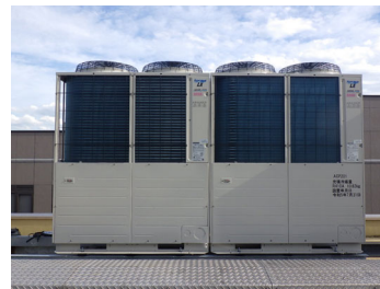
屋上 空調室外機
