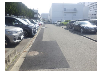
学術支援センター（動物実験施設） 西側 屋外排水管
