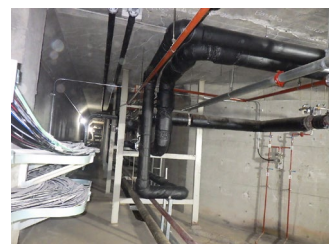
共同構内 屋外給水管、屋外消火管
