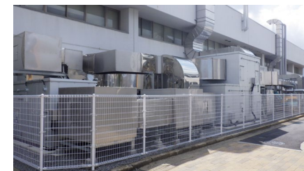
屋外 特殊空調機器
