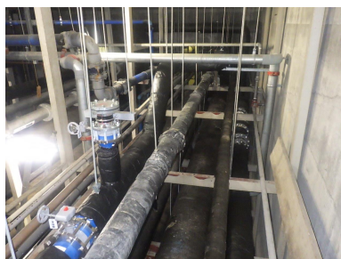
共同構内 屋外給水管
