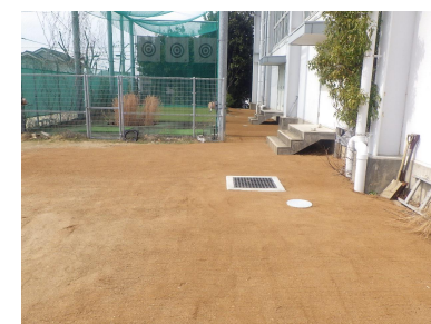
体育館南側 屋外排水管
