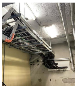
地階 発電機室 ケーブルラック配線
