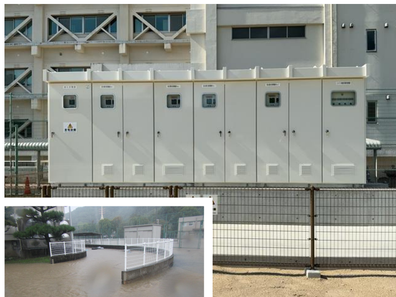
屋外受変電設備
