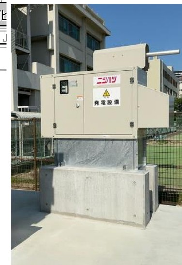
屋外 非常用発電機
