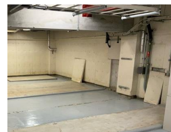
地階 電気室【撤去後】
