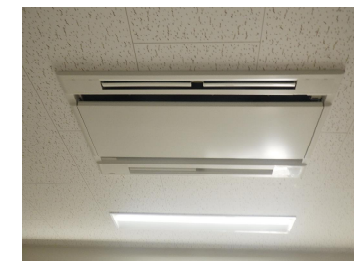
屋内 空調室内機
