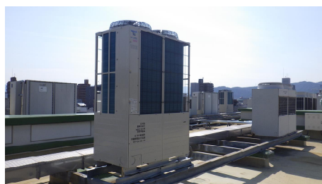
屋上 空調室外機
