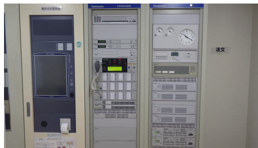
社会共創学部本館/総合研究棟2 非常警報設備
