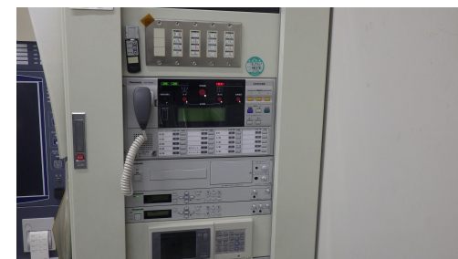
総合情報メディアセンター 非常警報設備
