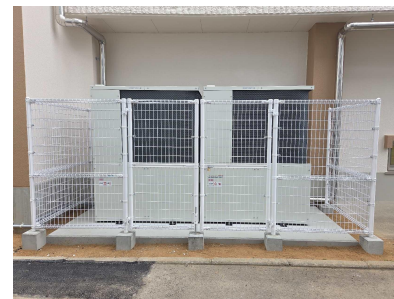
空氣調和設備(室外機) 外觀
