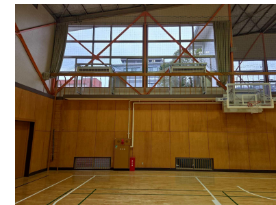
空気調和設備(室内機) 内観
